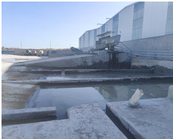
砂石分离器和三级沉淀池
