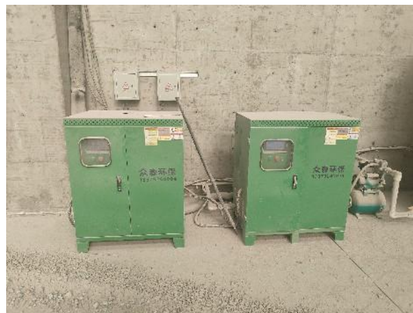
喷淋洒水控制系统
