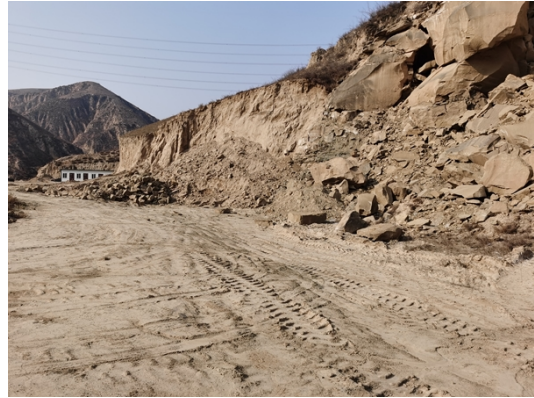
照片 3.2-3 B2 崩塌隐患 (左侧) 镜向60°
