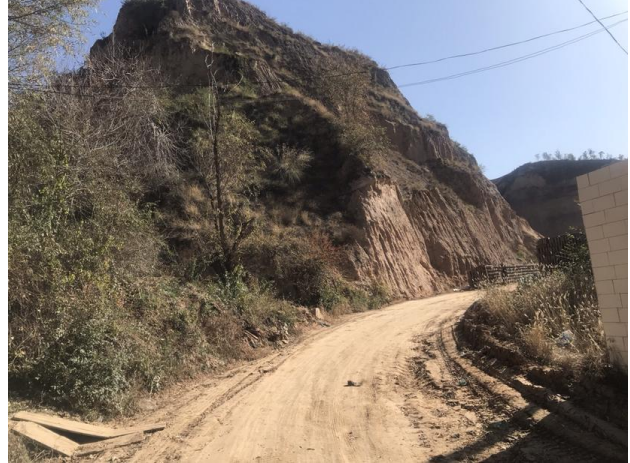
照片 3.2-2 B1 崩塌东侧 镜向 130°
