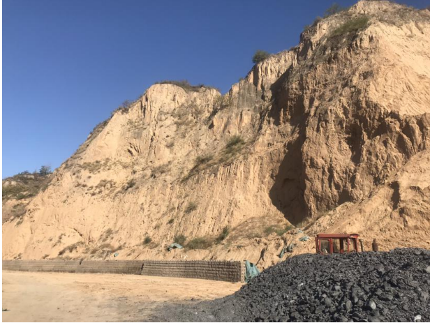
照片 3.2-1 B1 崩塌西侧 镜向 230°
